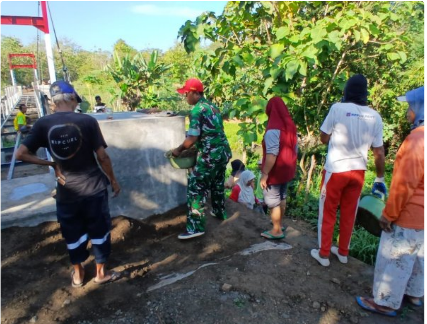
Warga Dan TNI Gotong Royong Ratakan Jalan Menuju Jembatan Garuda Di Karangpaket
